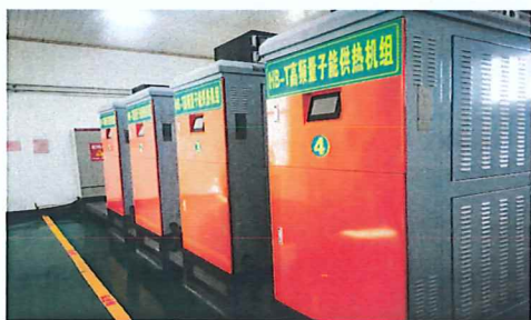
4.原州区清洁取暖设备图片
