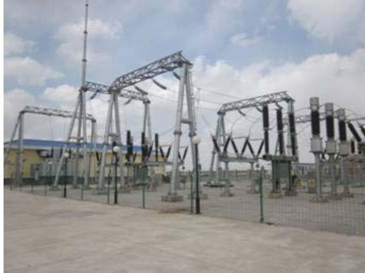
图 6-6 110kV 升压站（同类项目）
