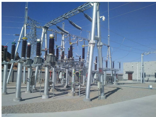
110kV 升压变电站及站房
