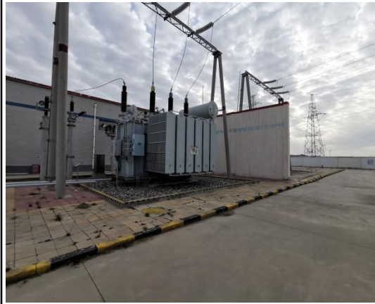
主变压器及事故油池
