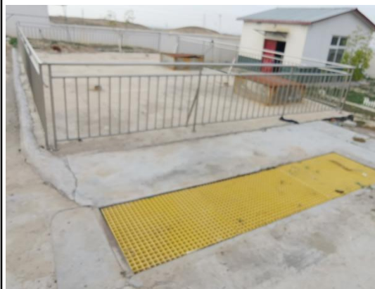
污水处理设施
