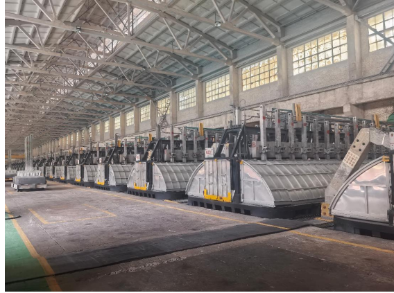
200kA 电解车间内部
