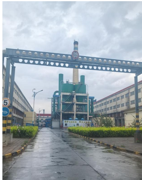
焙烧烟气脱硫塔
