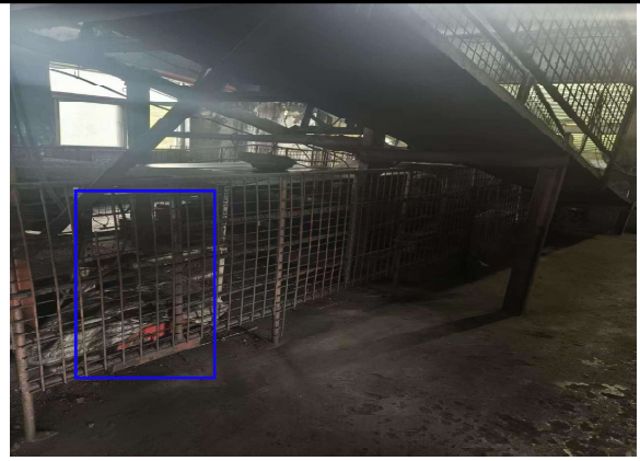
运煤隧道驱动机房内 X 射线机安装位置（位于二楼，设置 1.2m 高防护网）
