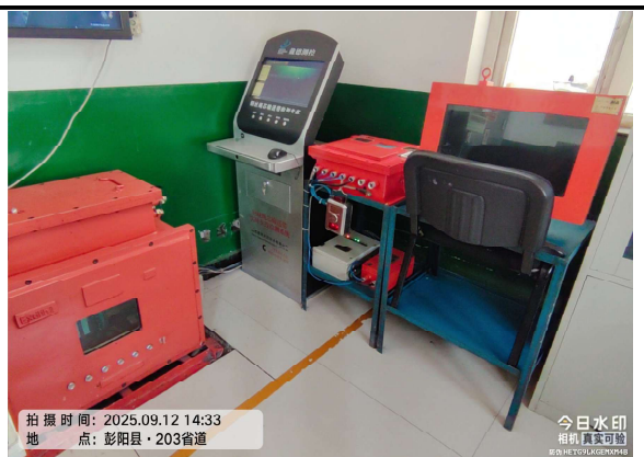
主井皮带机房内地面操作台
